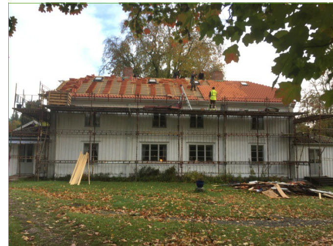
Nytt tegel läggs på efter att både takpapp och läkt bytts ut
